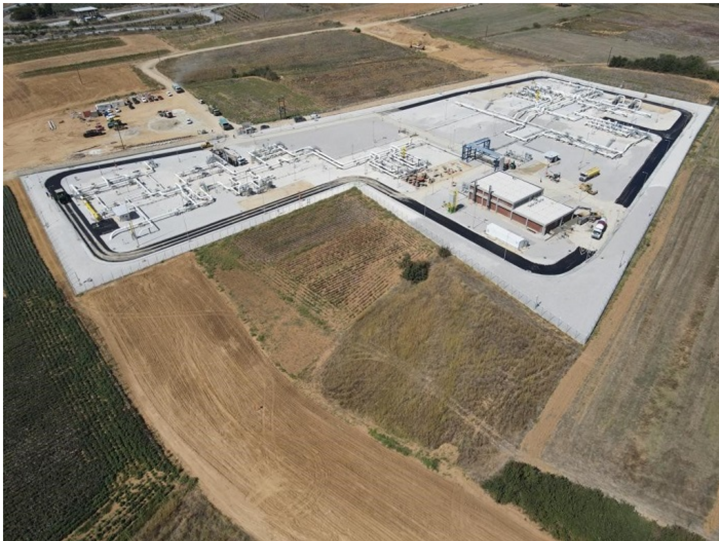
Αεροφωτογραφία του μετρητικού σταθμού Κομοτηνής.
